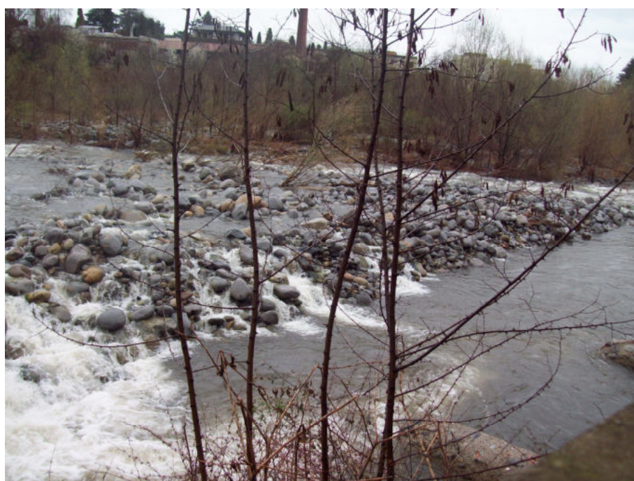
Figg. n.36-37: Alveo del torrente Cervo in prossimità dell'argine destro costituito da vecchi edifici industriali; sono visibili ciottoli decimetrici e massi, alcuni dei quali con un diametro di circa 0,5 mt, che avanzano, sospinti dalla corrente di piena a mò di "Cingolo", i sedimenti grossolani sono successivamente dilavati da normali portate come quella visibile nella foto. L'alveo in alcune zone presenta una granulometria eterogenea che favorisce l'attecchimento della vegetazione. L'inclinazione del fronte ciottoloso è compreso tra 20 e 30 gradi. La successiva piena farà avanzare il fronte ciottoloso. Praticamente è quello che si è verificato in Bessa ove il flusso idrico era considerevolmente maggiore e su una maggiore superficie. Il flusso idrico visibile nelle foto, praticamente privo di materiale solido, dilava i ciottoli eliminando le granulometrie fini (argilla, limo, sabbia e ghiaia).
