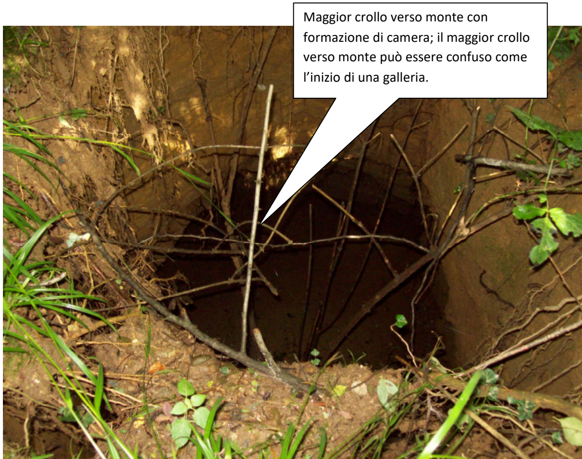
Fig. 173: il crollo di materiale si è allargato verso monte creando una “camera” con diametro maggiore del “pozzo”.
